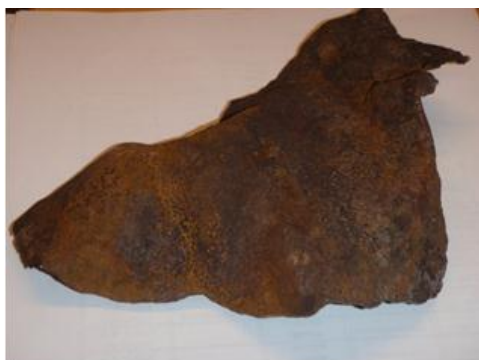
Denne fliken av røret ble revet av og viser kraftig korrosjon
