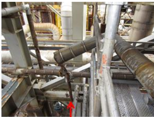
Røret oppstrøms bruddstedet har svingt til venstre og vridd seg kraftig
