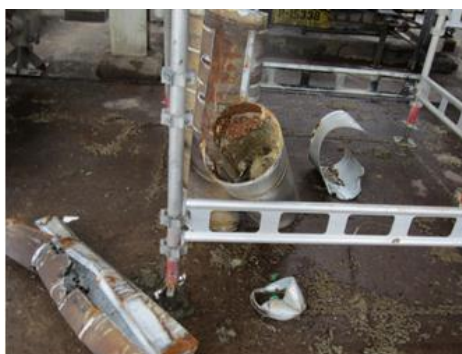
Rester av metallkappen ble kastet av røret
