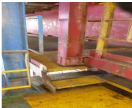
Bilde 1: Rømningsvei blokkert med posisjonen til boremodulen
