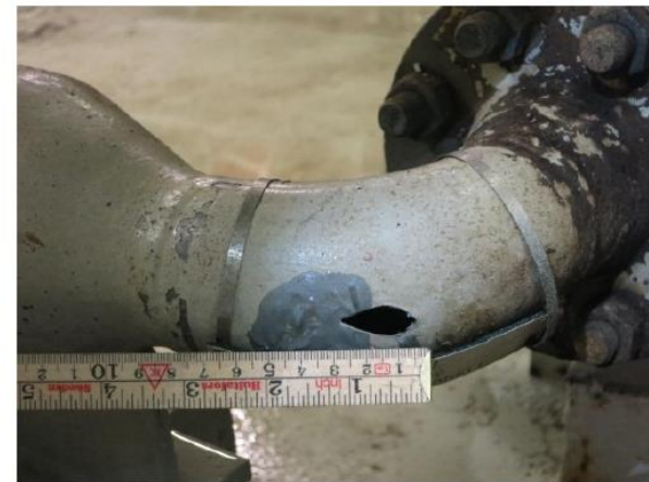
Figur 6 Hull erodert i bend, foto: Statoil
